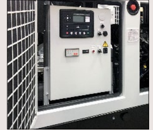
QUADRO CON CENTRALINA AGGIUNTIVA DI EMERGENZA CONTROL PANEL WITH BACK UP CONTROLLER
